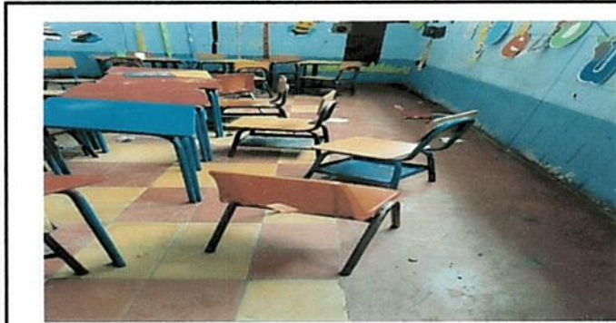
Foto 3: Piso de las aula dañado por las raíces de los árboles
