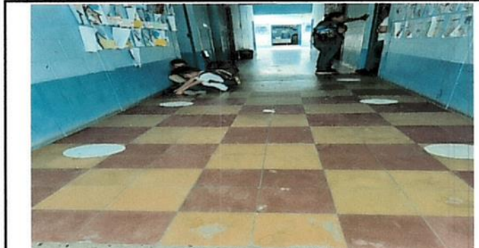
Foto 4: Piso del pasillo dañado por las raíces de los árboles
